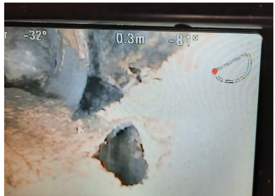
Bild 1: Schadstelle am Abwasserrohr innerhalb der Vorsatzwand Quelle: Geschäftsleitung AWWWW
